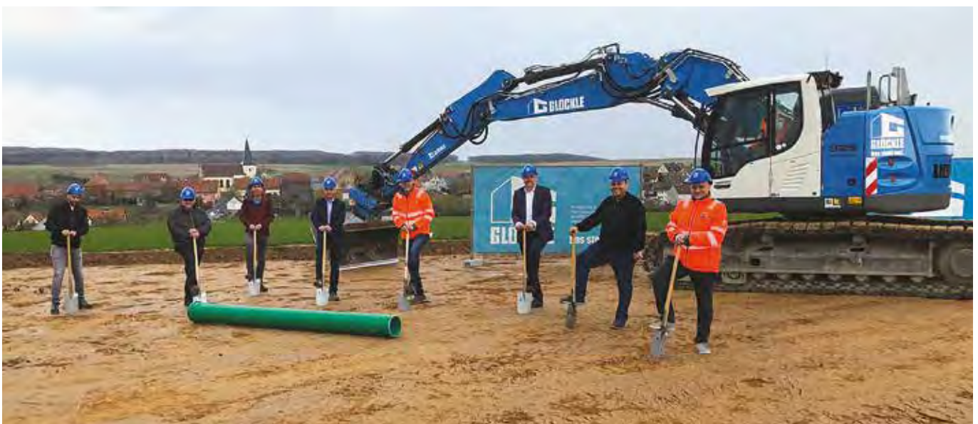
Von links nach rechts: Alexander Kempf, Michael Löhe, Christian Dehmer, Peter Leimeister (Tiefbautechn. Büro Köhl), Bürgermeister Bernhard Weidner, Timo Becker (Bereichsleiter Bauunternehmung Glöckle), Marco Göbet, Oliver Werner (Fachbereich Bauen + Planen, Markt Rimpfar)
