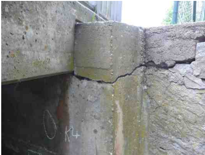
Widerlager abgedrückt im Kopfbereich
