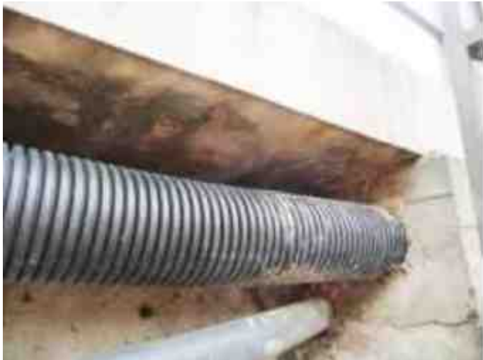
Durchfeuchtungen Roststellen Unterseite
