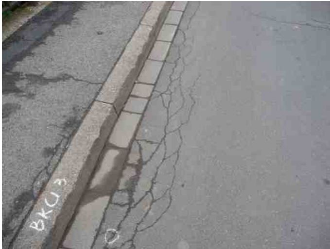
Asphaltbelag rissig, durchlässig
