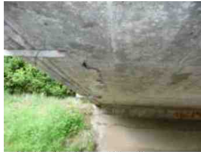
großflächige Abplatzungen Unterseite
