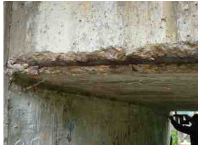
starke Korrosion mit Querschnittsverlusten
