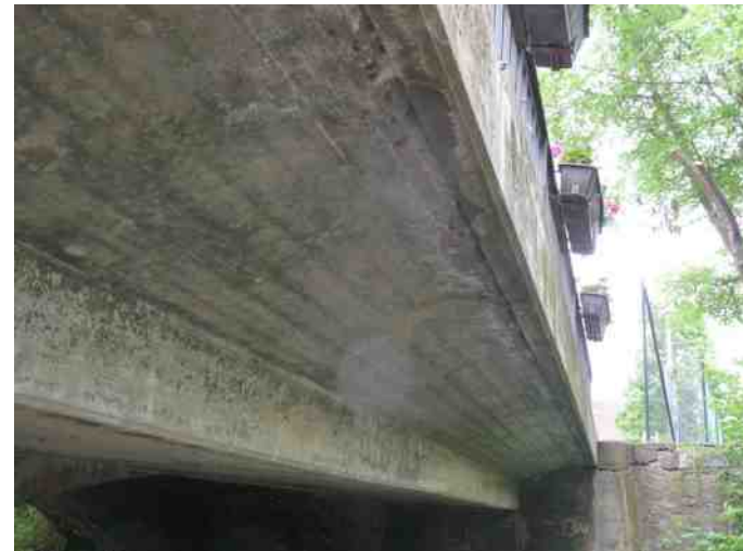
Unterseite mit Durchfeuchtungen und Ausblühungen
